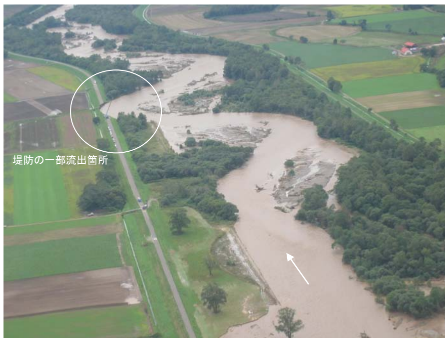
写真 3-4 堤防の一部流出箇所全景（上流側から撮影。H23.9.7 PM1:49 撮影）
