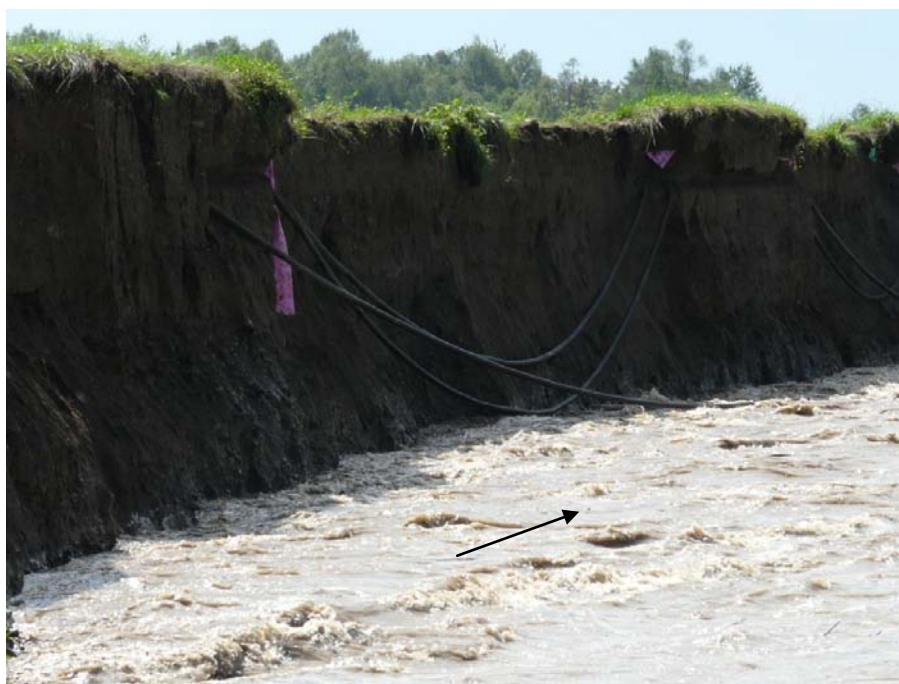
写真 3-3 流出部の侵食面（上流側から撮影。H23.9.7 AM10:14 撮影）
