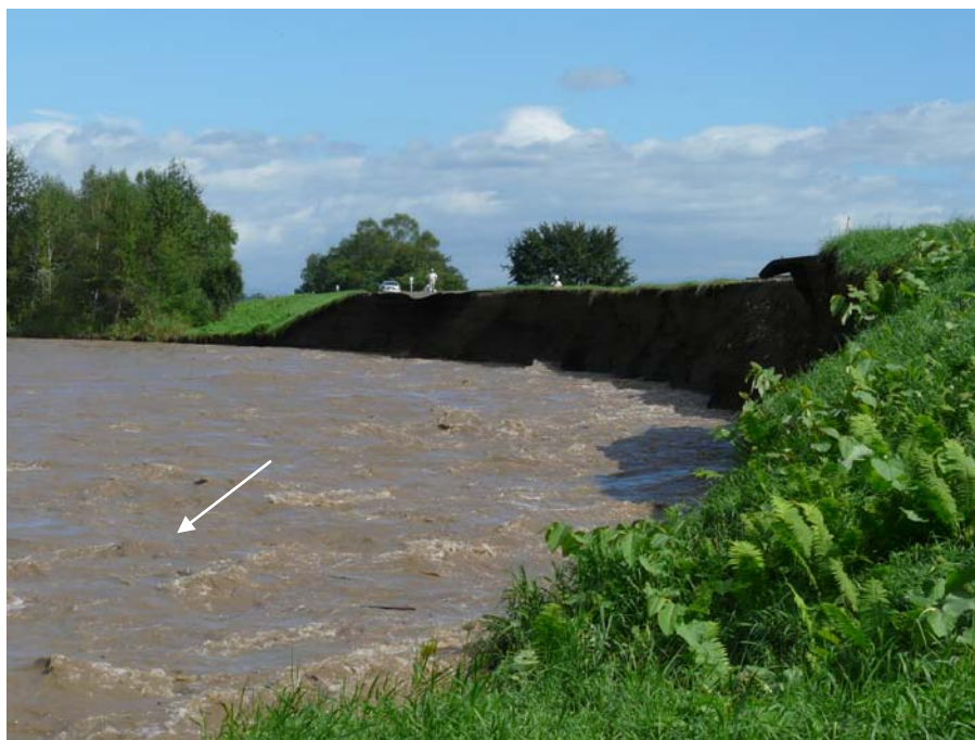
写真 3-2 堤防の一部流出箇所（下流側から撮影。H23.9.7 AM9:24 撮影）
