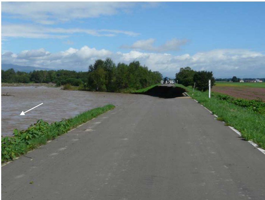
写真 3-1 堤防の一部流出箇所（下流側から撮影。H23.9.7 AM9:38 撮影）
