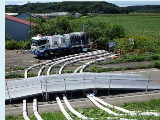
ポンプ排水状況(安骨樋門)
