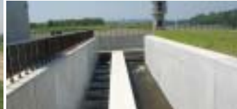
千代田分流堰に整備された階段式魚道
