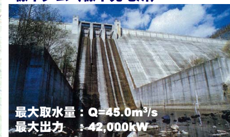
活込ダム（足寄発電所）
