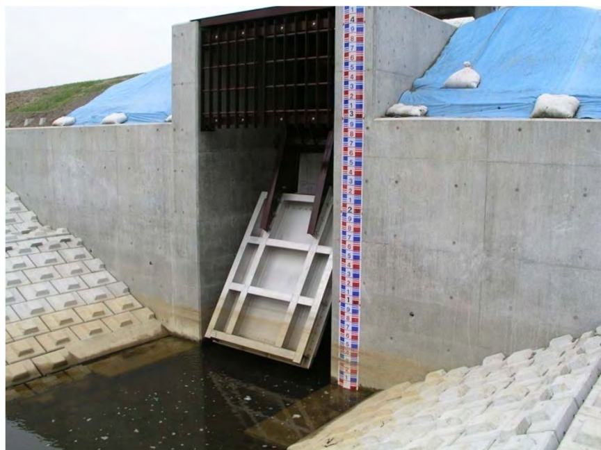
フラップゲート（浦幌十勝川）
