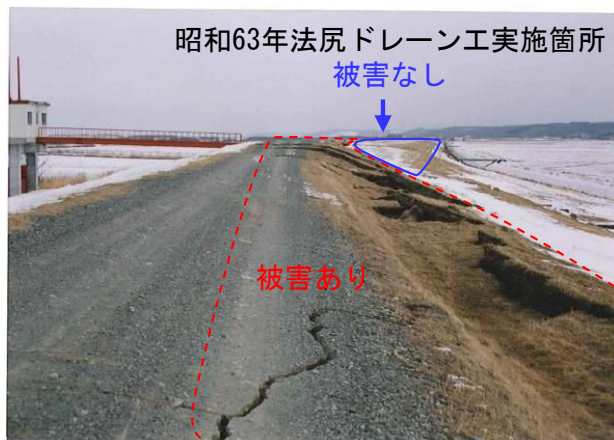
平成5年釧路沖地震被災状況（統内築堤KP33付近）
