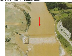
千代田堰堤の被災状況（池田町）
