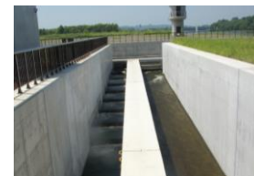
千代田分流堰に整備された階段式魚道
