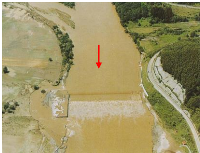
千代田堰堤の被災状況（池田町）
