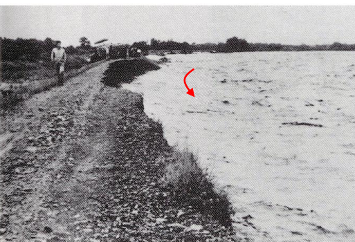
決壊した札内川右岸加賀築堤（帯広市）
