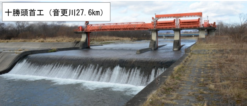
魚道がなく遡上が困難
