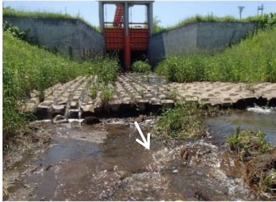
樋門出口水路の不連続
