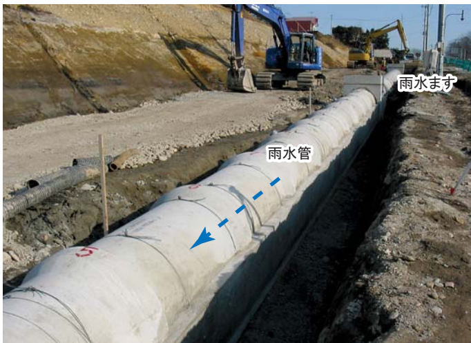
広い範囲から水が集まる太い雨水管。
