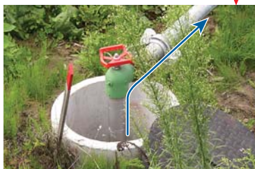
給水栓。水まき機につなぐ。
