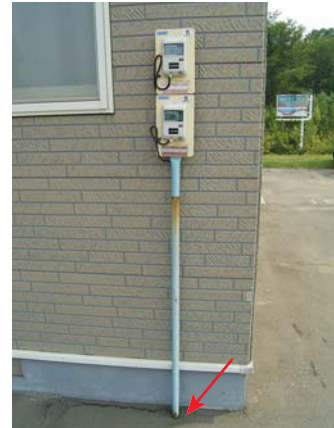
水道メーター。水が流れた量を土の中で計っている。
