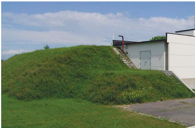
配水池の一つ。土でおおわれているタイプ。
