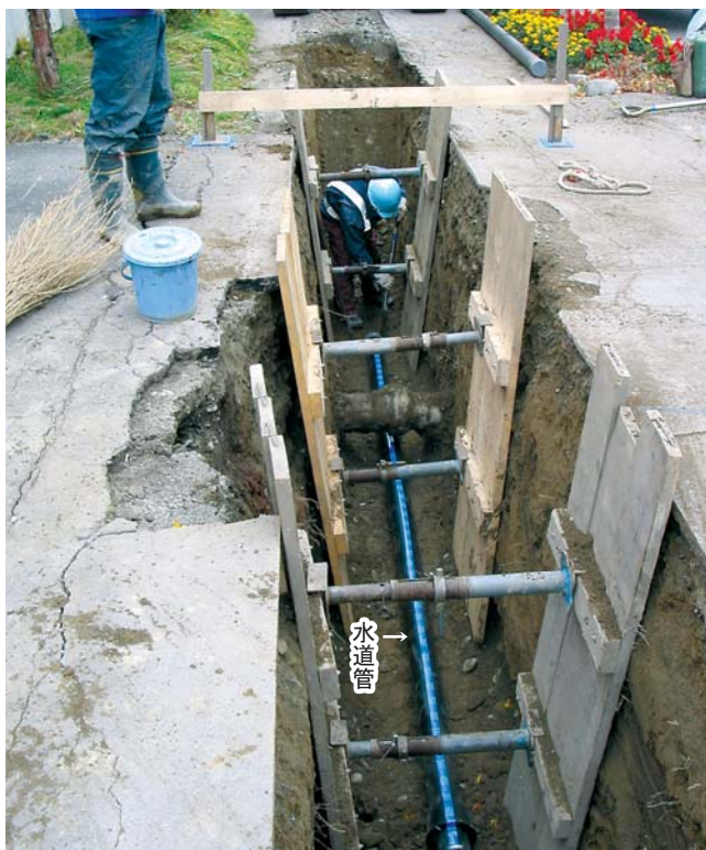
家などに水を配る上水道管。こおらないように深くうめられる。
