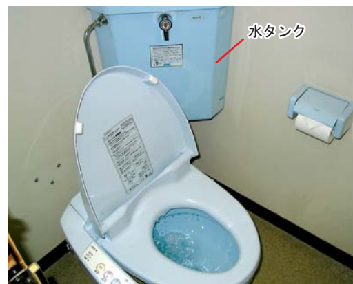
水をため、高さの力で流す水洗トイレ。
