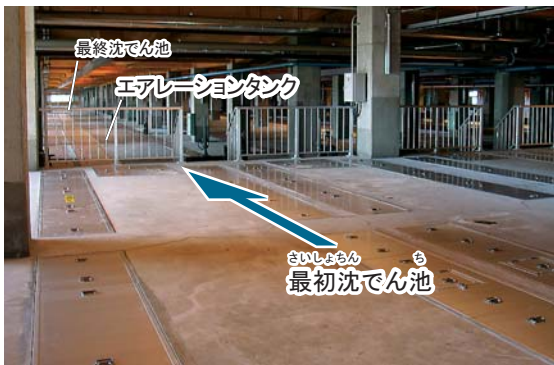
とかがわりゅういさげすいどうじょうか 十勝川流域下水道浄化センターの内部。 手前は最初沈でん池で、おくにエアレーションタンク、その向こうに最終沈でん池がある。(下図参照)
