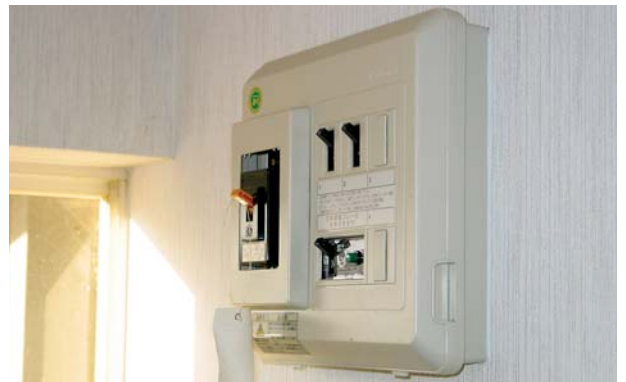
分電盤。各部屋に電気を分ける。
