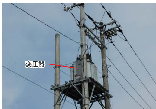
電柱に取り付けられた変圧器（トランス）。
