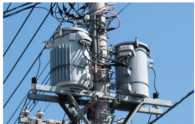
電柱にある変圧器。(→ 電柱と変圧器 p45)
