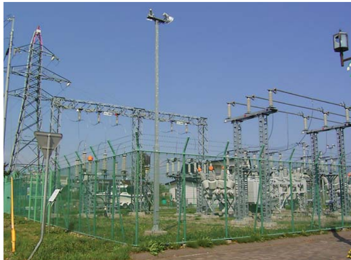
変電所。ここで電圧を調整して、地域に分けて配る。
