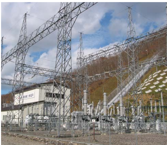
発電所にある変電施設。電気を遠くに送るため、電圧を高くする。(→ 発電所 p48)
