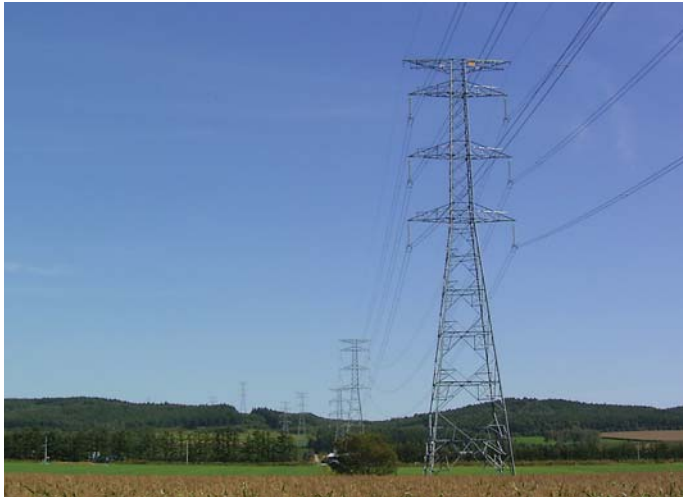
送電線と鉄塔。電気は遠くから送られきて、遠くへ送られていく。
