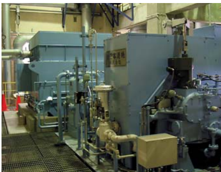
蒸気タービン発電機（※4）。
