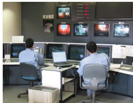
焼却中央制御室。ゴミが燃やされる状態などを監視している。
