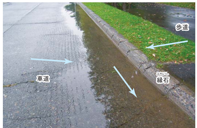
歩道は車道側に、車道は歩道側にかたむいていて、縁石沿いに水が集まって流れる。
