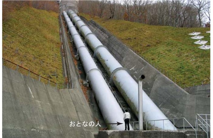
めとうだいに はつでんしよ 芽登第二発電所へ水を流す管。近くで見るとかなり大きなもの。
