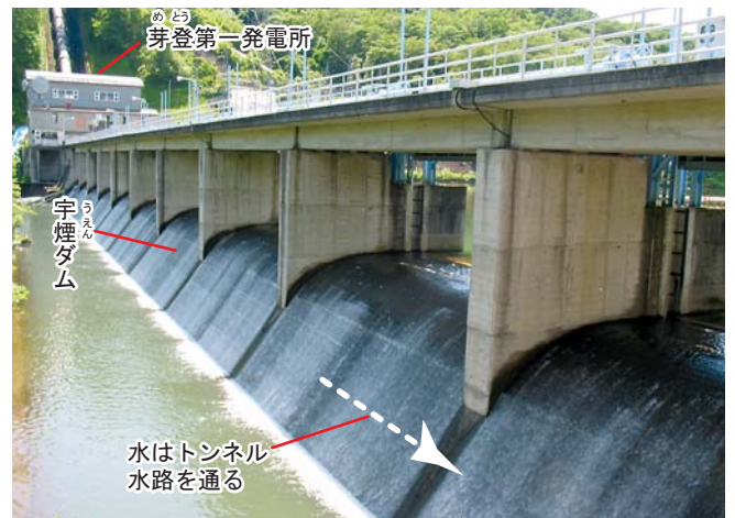
宇煙ダム(美里別川)。芽登第一発電所のすぐ前にある。ここで取られた川の水と発電所から出た水が、トンネル水路を通して送られる。
