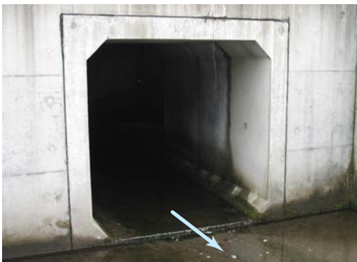
① 雨水管の出口。
