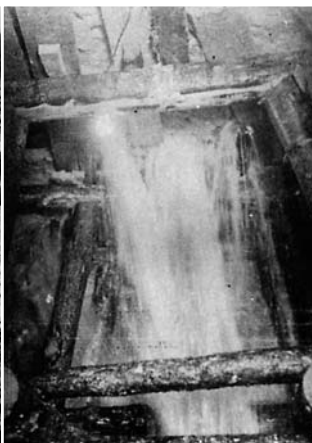
足寄発電所へのトンネル水路工事。わき水があふれ出ている。
