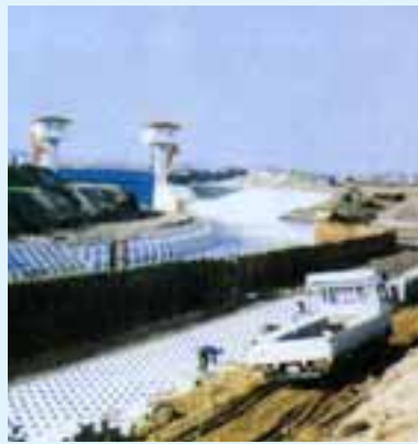
工事中の導水路。後ろが導水門。 （写真：『十勝川写真で綴る変遷』より）
