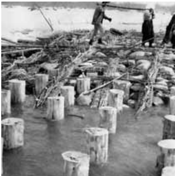
流れの中にくいをならべて打ちこみ、土砂をためる「並杭水制」。(写真:『十勝川写真で綴る変遷』より)
