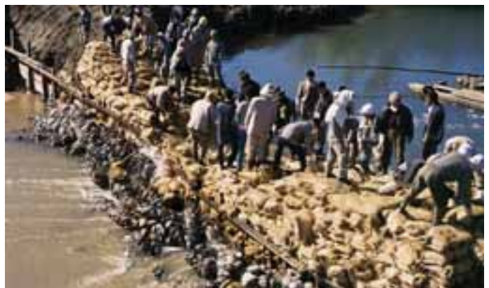
土のうなどによって十勝太(浦幌町)へ向かう流れが止められた。「十勝川が止まった!」との声が上がったという。(写真:『十勝川写真で綴る変遷』より)
