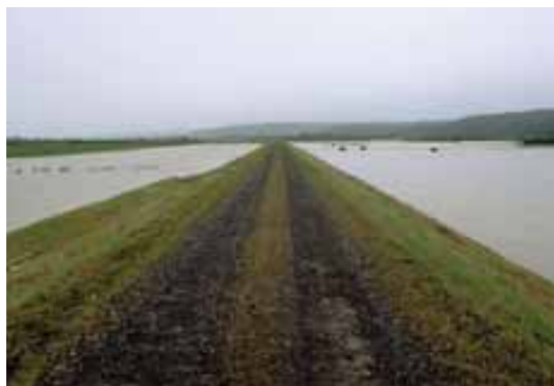
洪水 こうずい の時の利別川堤防 としべつがわ から見たところ。利別川 としべつがわ の水が増え ふ （右側）、流れ出せなくなった水がたまっている ふ （左側）。
