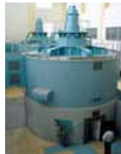
糠平発電所(上士幌町)の発電機。
