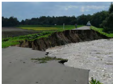
写真-2 堤防流出箇所 (KP18.2左岸:音更町東音更)
