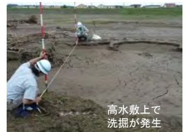
写真-7 平成23年9月出水後の高水敷の洗掘状況(H=0.9m)
