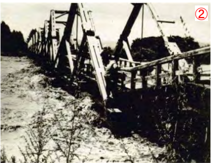
▲昭和37年8月洪水 落橋寸前の大正橋(帯広市)
