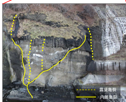
写真2：穴澗トンネル直上斜面の亀裂
