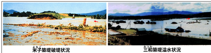
米子築堤破壊状況
