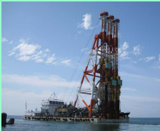
北防波堤設置箇所の地盤改良 （サンドコンパクション船）
