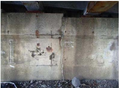
橋台損傷（鉄筋露出・ひびわれ）
