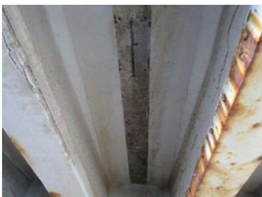
床版損傷（鉄筋露出）
