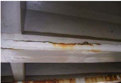
主桁損傷（ひびわれ）
