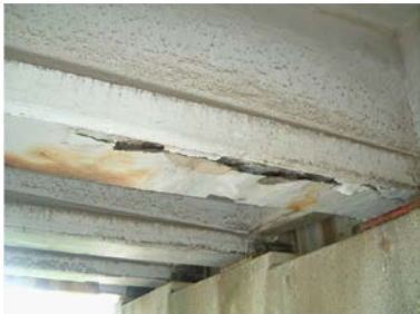
主桁損傷（剥離・鉄筋露出）
