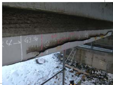
主桁損傷 (ひびわれ)
