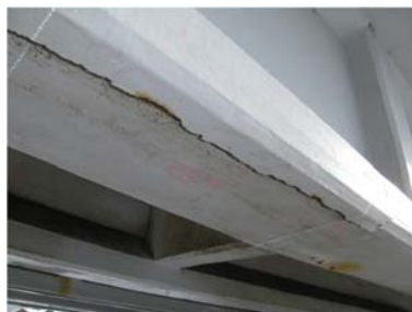
主桁損傷 (ひびわれ)
