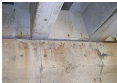
橋台損傷 (剥離・鉄筋露出)
