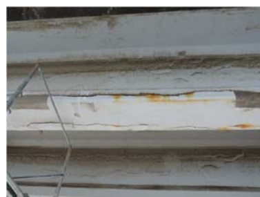
主桁損傷 (ひびわれ)
