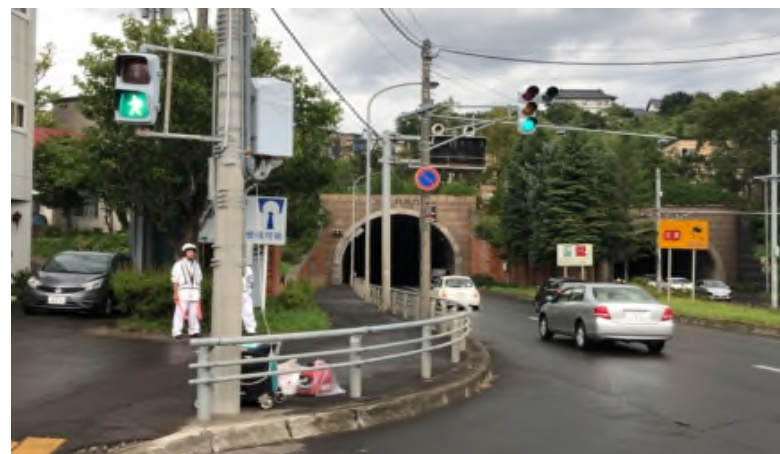
9月7日 信号への電源供給支援(発動発電機)
