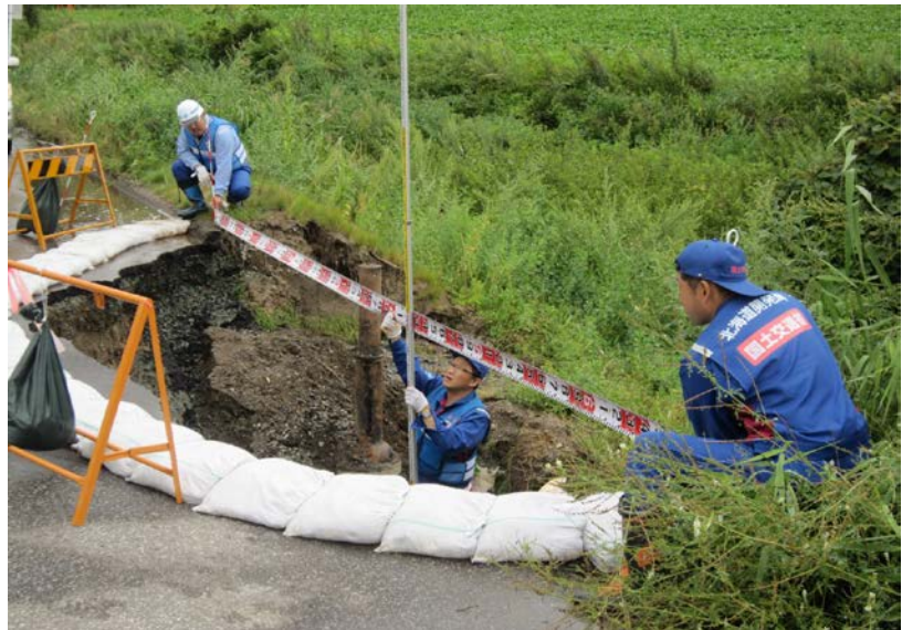
8月28日 北見市常呂町で被災箇所所の現地調査
