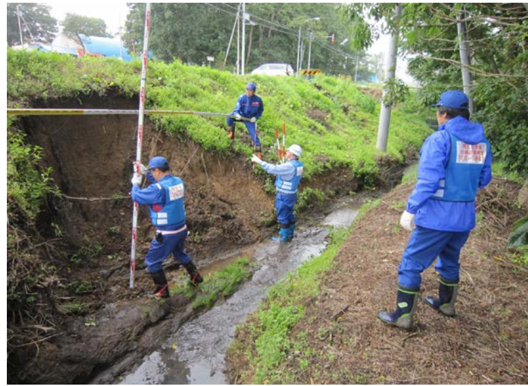
8月28日 北見市常呂町で被災箇所所の現地調査
