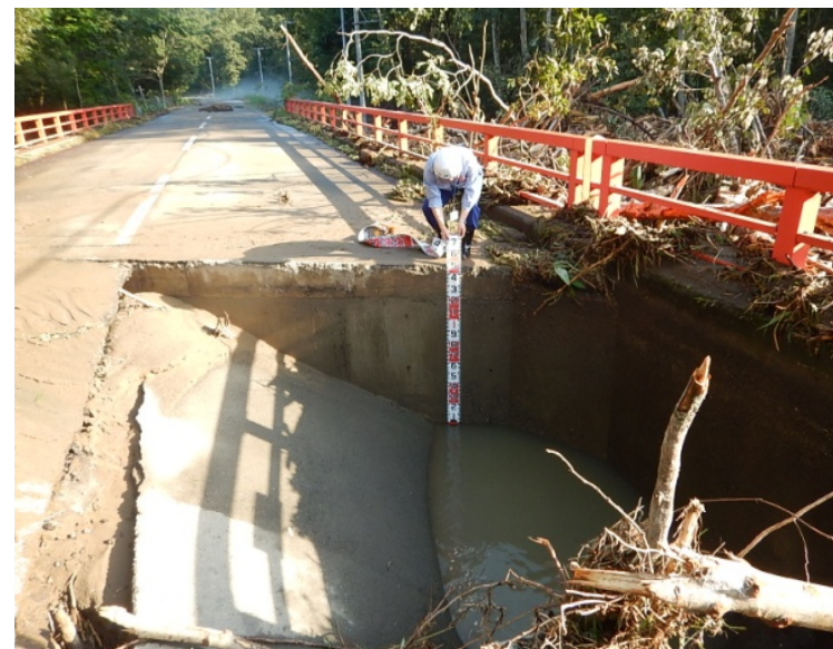
9月1日 芽室町橋梁被災箇所調査(道路班)
