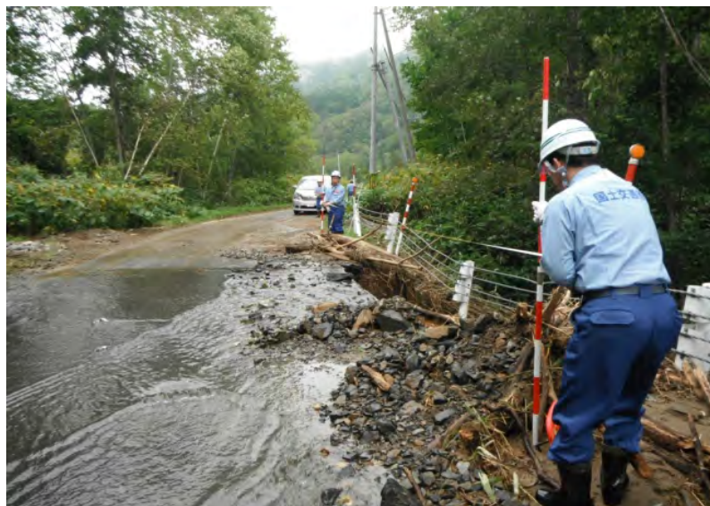
9月4日 芽室町道の路肩決壊箇所調査1(道路班)
