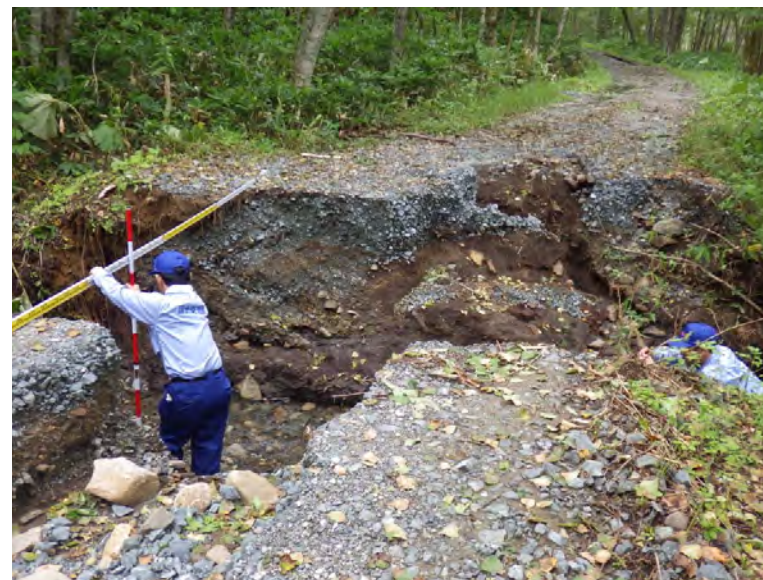
9月4日 パンケヤーラ川被災現場調査(河川班)
