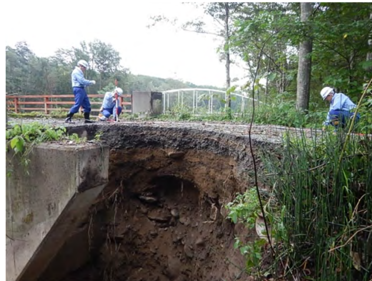
9月3日 西伏見橋被災調査(道路班)
