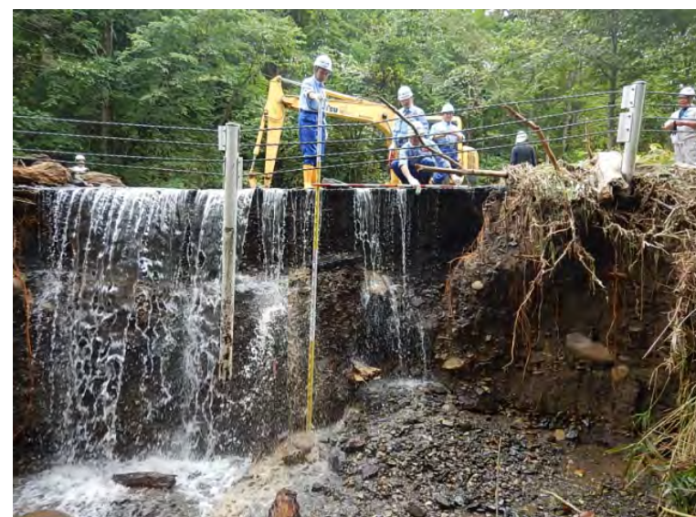
9月4日 芽室町道の路肩決壊箇所調査2(道路班)
