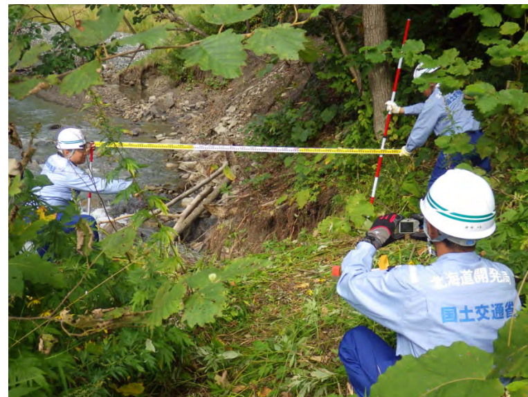
9月3日 南富良野町管理河川被災状況調査(河川班)
