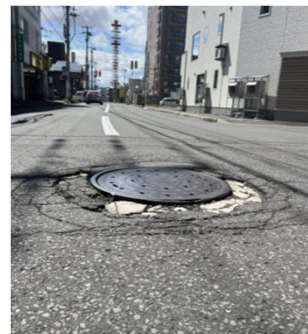
除雪時に障害となり得るマンホール
