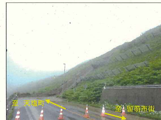
被災写真(全景)
