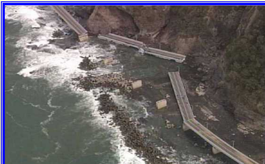
H16.9 一般国道229号大森大橋落橋の様子(神恵内村)
