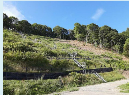
急傾斜地崩壊対策施設の整備状況
