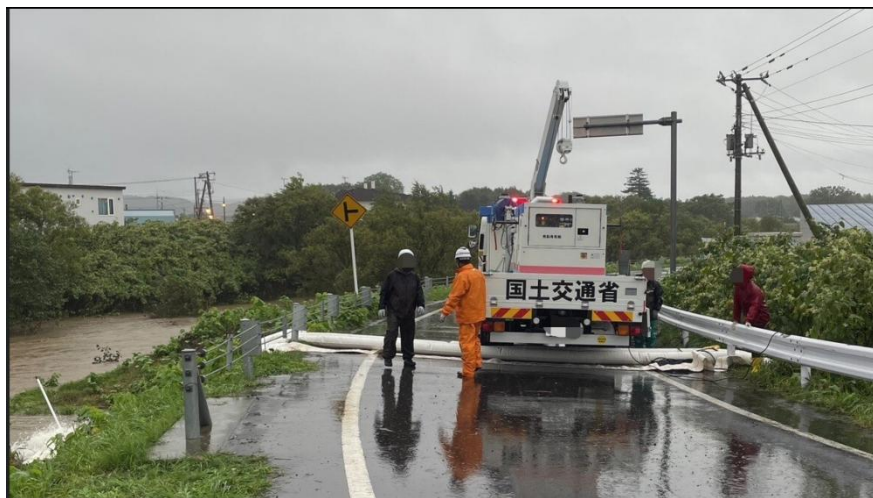
排水ポンプ車出動状況(豊富町)
