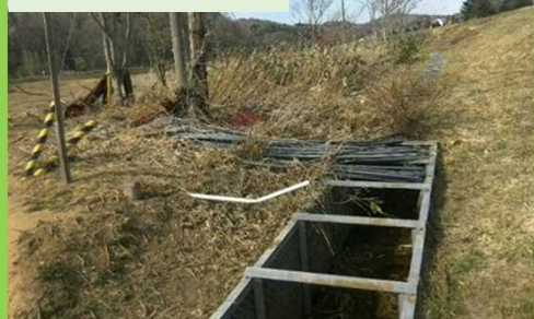
留萌ダム付近 捨てられた鉄パイプ
