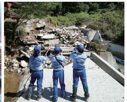
被災状況調査(熊本県球磨村)
