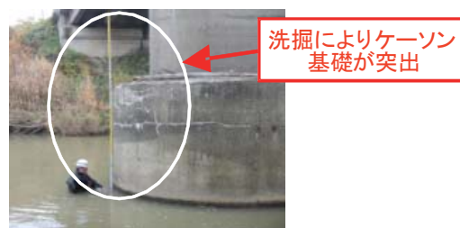
写真：基礎の洗掘
