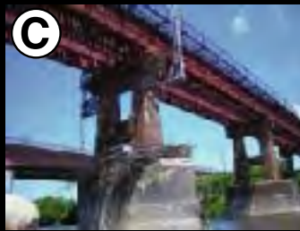
鉄橋ですよ。橋脚に流木がのってます。
