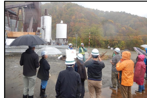
CSG・コンクリート製造設備ヤード
